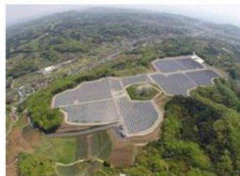
太陽光発電所
