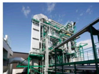
バイオマス発電所
