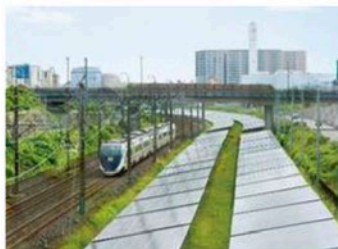
太陽光発電所
